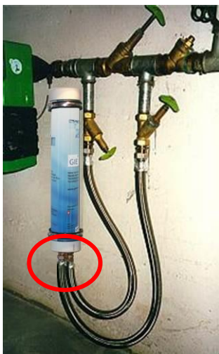
El activador instalado por debajo del conducto de Agua, con las conexiones hacia abajo
